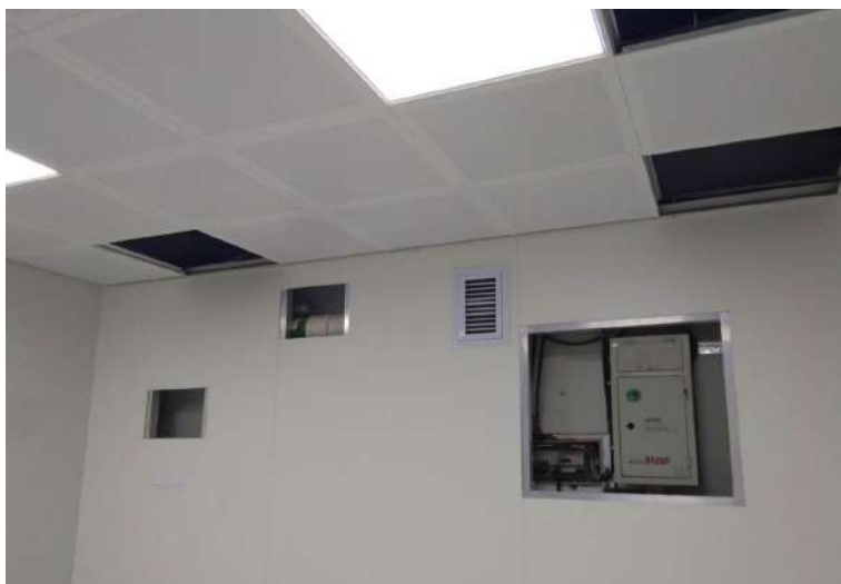
湖南大学空气载能辐射空调实验室 ACERS Laboratory in Hunan university
